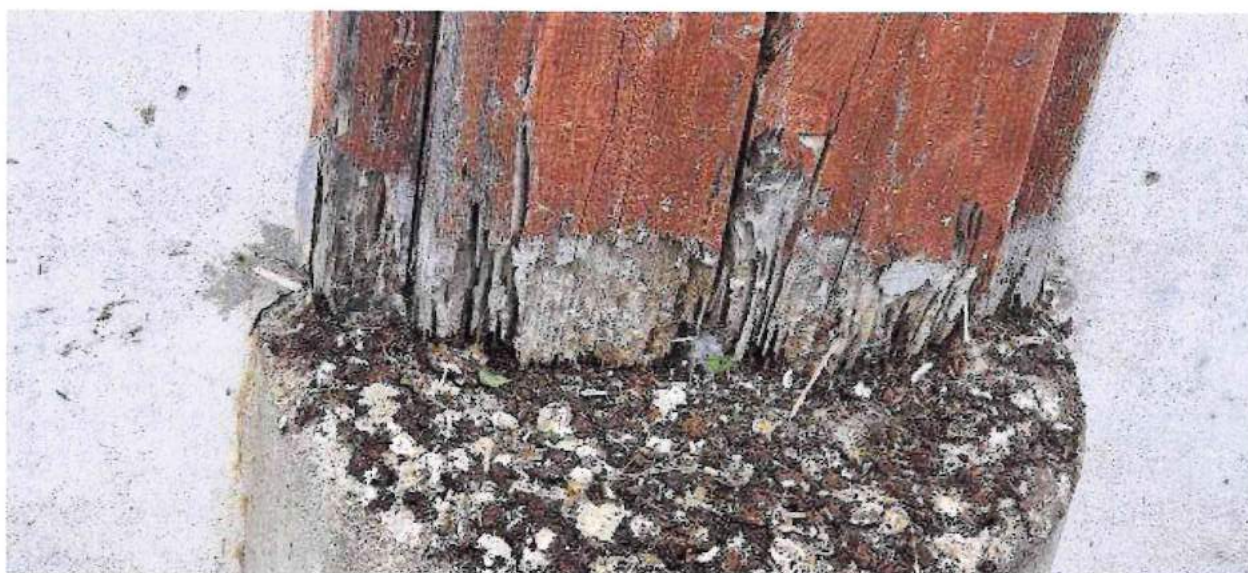
DEGRADO PRESENTE IMMEDIATAMENTE AL DI SOPRA DEL GUSCIO IN CLS
